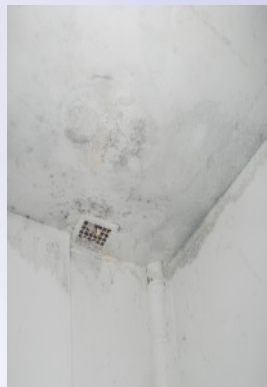
Schimmelbildung in Wohneinheiten
